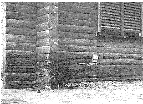
写真1-2 写真1-1の外壁足元部の詳細。下から4段分のログが著しく変色している
