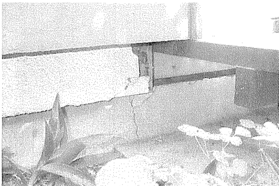
写真15 基礎の立ち上がりひび割れ
