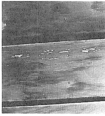
腐朽によるすじ状痕
