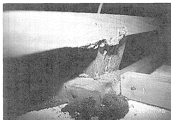
写真5 木材の接合部や割れ目につけられた 蟻土（1階天井裏の柱、梁、野縁など）
