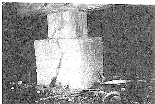
写真4 東石と東柱につくられた ヤマトシロアリの蟻道
