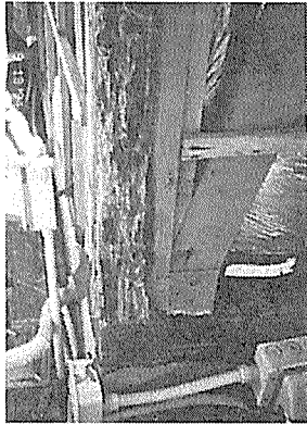
柱の白色腐朽
