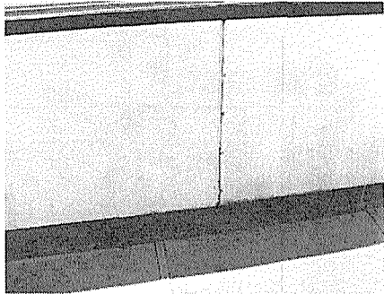
写真4.1-5 バルコニー手すり壁。防水層立ち上がりの不備、笠木、壁仕上げの目地シール切れやひび割れ等注意すべき点が多い。
