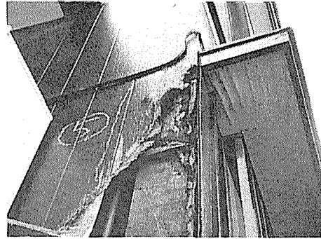
写真4.1-4 壁面庇上面端部の水仕舞が悪いと、この事例のように壁内への雨水浸入を招く恐れが大きい
