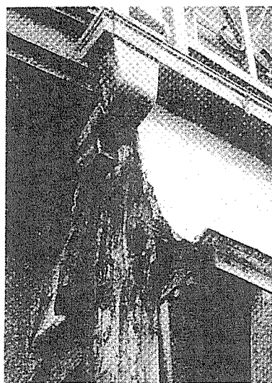
写真 2-1 縦樋からの雨水漏水による柱の劣化被害
