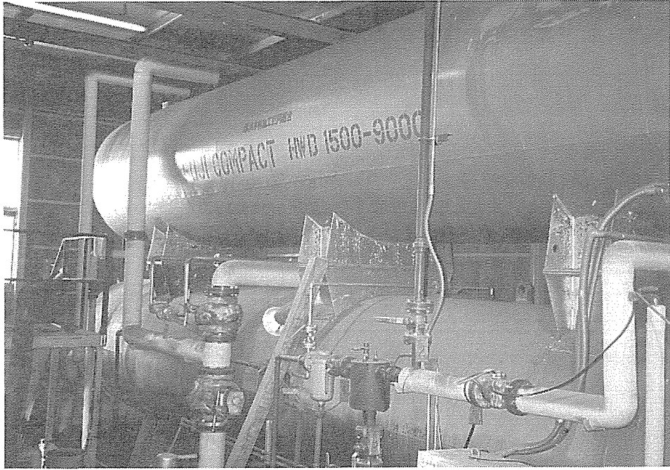
写真-7 木材防腐処理装置
